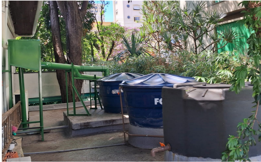
© RR setec hidrobrasileira
